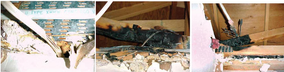
Figura 80: Imágenes de siniestro debido a conductores dañados, suministradas por el inspector jefe de incendios en Peoria, Arizona, EE.UU. [37]
