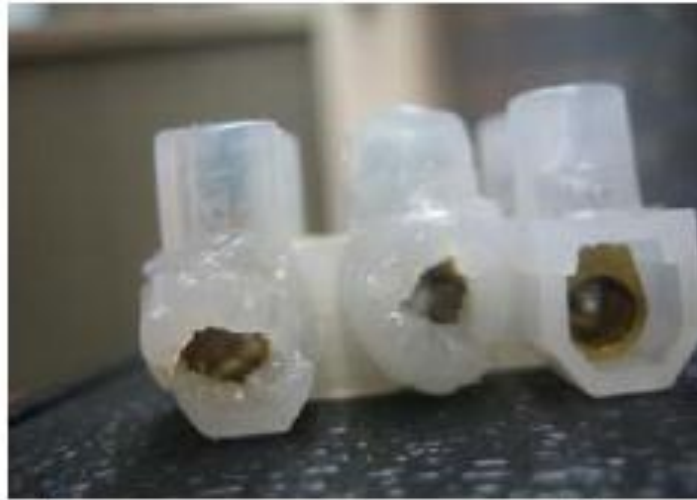
Figura 26: Deformación causada en una regleta de plástico como consecuencia de una falla de tipo resistiva, por mal contacto entre conductores y regleta [6].
