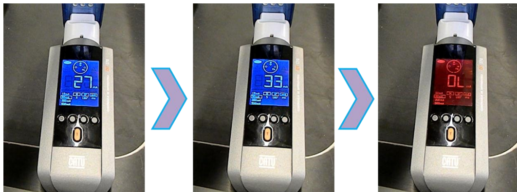
Figura 33. Secuencia de instrumento en instalaciones inspeccionadas. El display rojo indica falla en el dispositivo de protección diferencial.
