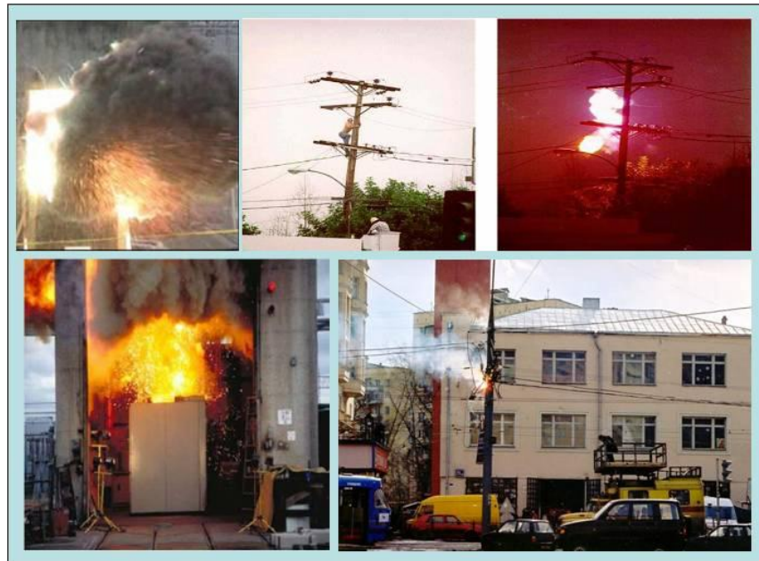
Figura 6: Diversas fallas de sistemas eléctricos en baja y media tensión, ocasionando descargas y/o explosiones por arco eléctrico.
